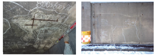
図-12 RC製シェッド 変状状況の例
