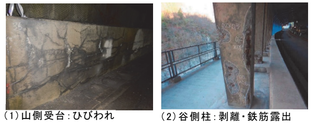
図-15 PC製シェッド 変状状況の例
