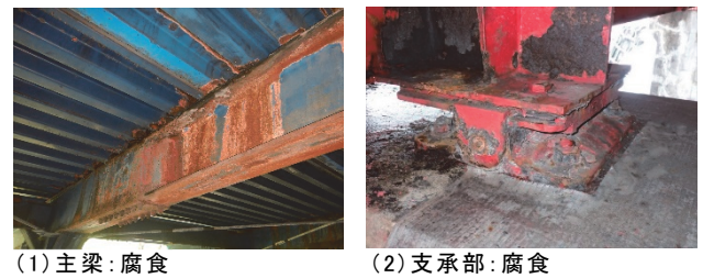
図-16 鋼製シェッド 変状状況の例
