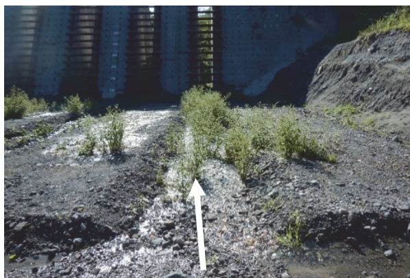
写真-6 降雨後の状況（2022年6月撮影）
