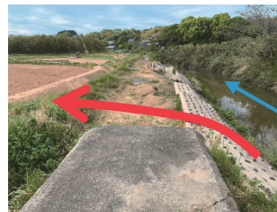
写真-3 破堤箇所
