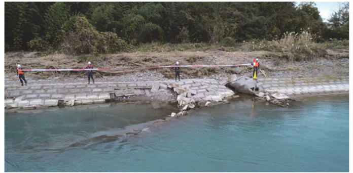
写真-1 鬼怒川（宇都宮市板戸町地先）の被災状況
