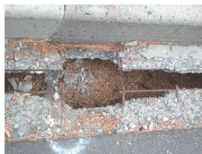
写真-1 DEFによって劣化した側溝の事例 1)
