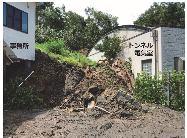
写真-3 地すべり下部（令和3年7月6日撮影）
