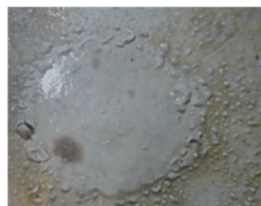
写真-1 有機酸による塗膜の劣化
