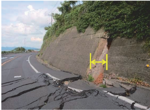
写真-2 8月18日17:00擁壁のズレ（終点側）
