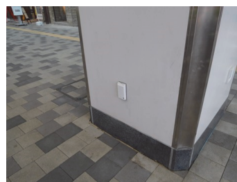
写真-3 コンセントボックス
