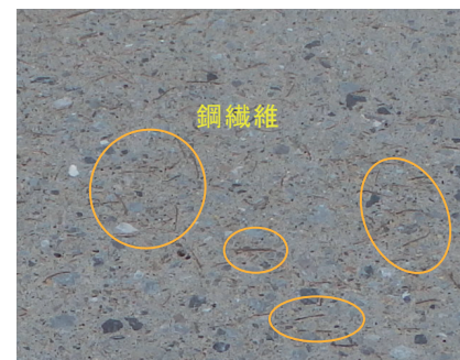
写真-1 鋼繊維のさび（SFRC舗装路面）
