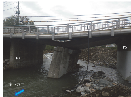
図-2 法雲寺橋被災状況 2)
