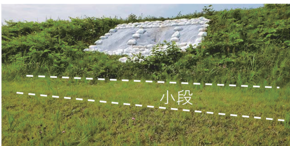
写真-3 最上川右岸81.5k付近の法面陥没
