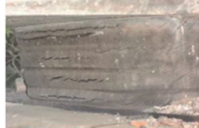
図-2 オゾン劣化による支承の亀裂
