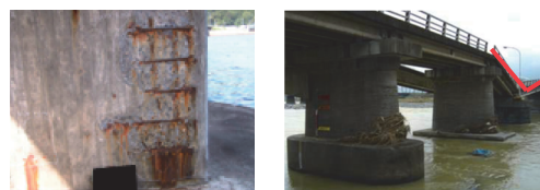
(塩害等の損傷事例) 3) (洗掘の被災事例) 4) 写真-1 下部構造の損傷や被災事例
