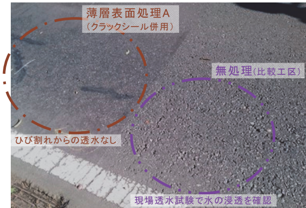
図-3 ひび割れ部から下層への浸透水調査測点の例
