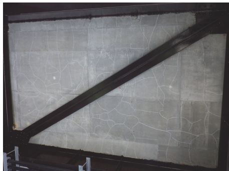
(b) 表層のひび割れと見られる事例 (M橋)
