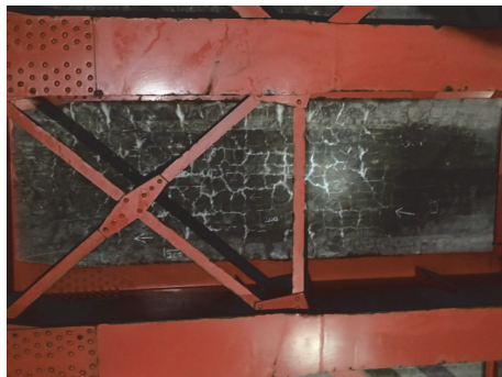
(a) 疲労によるひび割れと見られる事例 (E橋)
