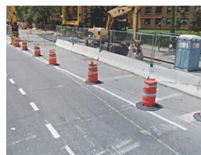
写真-2 緩衝施設の設置例
