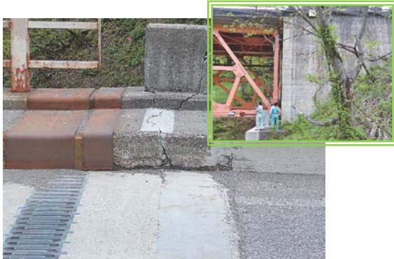
写真-7 ASRの膨張により隆起した路面
