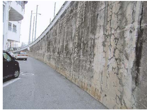
写真-4 ASRにより亀甲状のひび割れや変色が発生した橋梁取り付け道路擁壁
