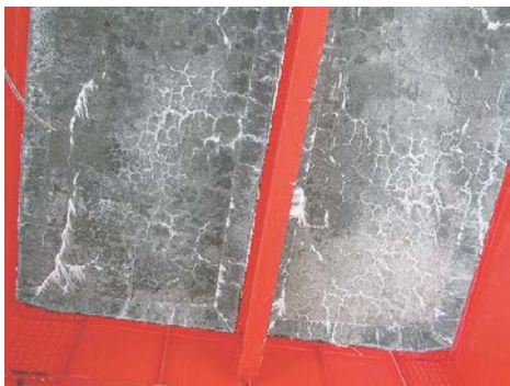
写真-8 ASRにより亀甲状のひび割れが発生したRC床版
