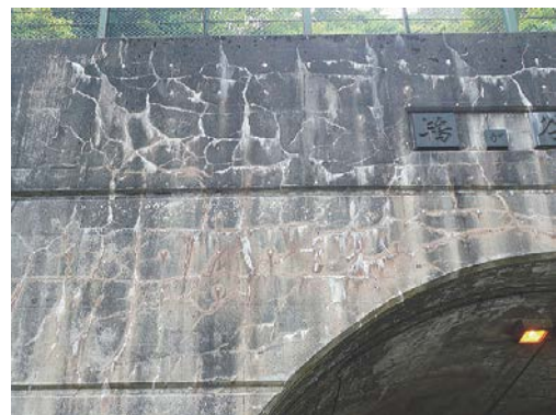
写真-6 ASRにより亀甲状のひび割れが発生したトンネル坑口
