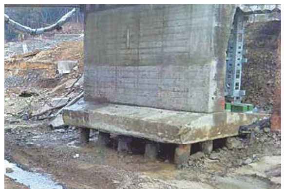
写真-13 二十一浜橋における橋台基礎の杭頭部の露出 （国土交通省東北地方整備局提供 2011年4月9日撮影）
