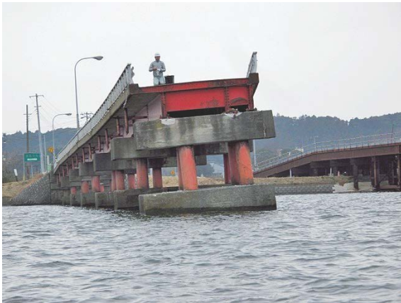
写真-4 パイルベント式橋脚を有する橋梁の上部構造落下（鹿行大橋）
