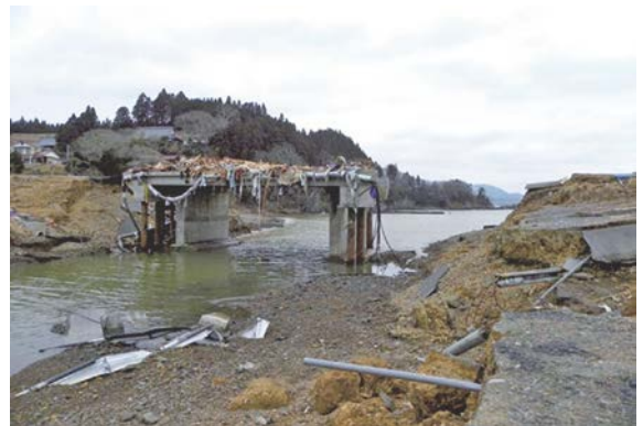
写真-12 二十一浜橋の橋台背面土の流出
