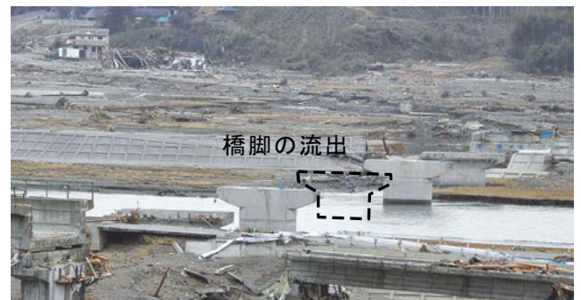
写真-6 小泉大橋上部構造、下部工流出状況
