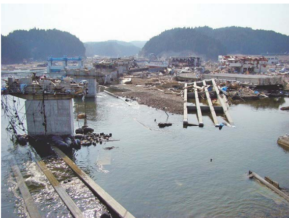
写真-10 歌津大橋の上部構造流出状況
