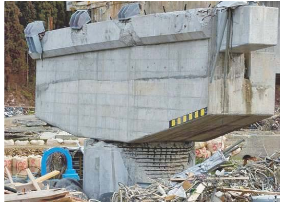
写真-11 歌津大橋RC橋脚の損傷
