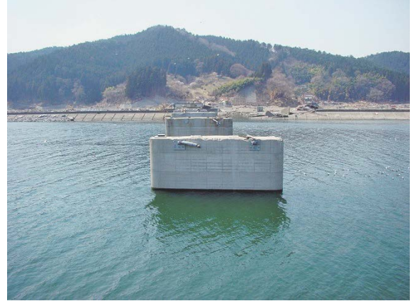
写真-5 気仙大橋上部構造流出状況
