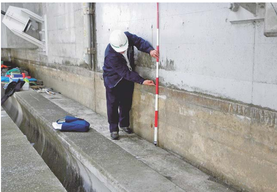
写真-14 美浜大橋における橋台前面護岸の沈下（約70cm）
