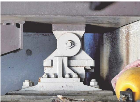
写真-15 美浜大橋の可動支承に生じた変位
