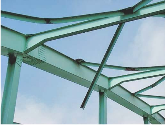
写真-3 下路ランガーアーチ橋の上横構の損傷（天王橋） 鹿行大橋（橋長405m、21径間単純合成鋼板桁、昭和43年竣工）は、パイルベント橋脚を有する橋梁で、3径間分の上部構造の落下（写真-4）が生じた。上部構造落下の原因については、現在調査中である。
