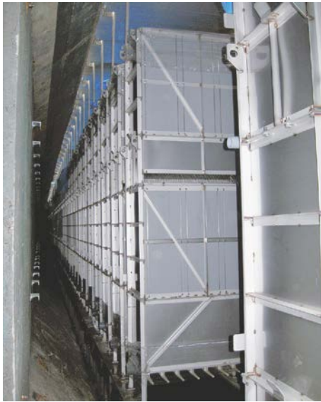
写真-1 MBRユニット設置状況
