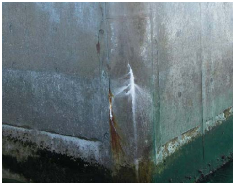
写真-3 P12橋脚に生じているひび割れ
