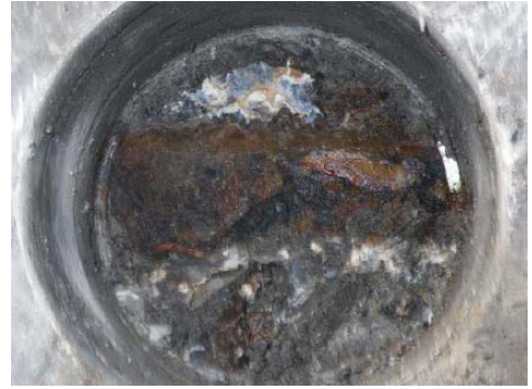
写真-4 P12ひび割れ直下の鉄筋の腐食状況
