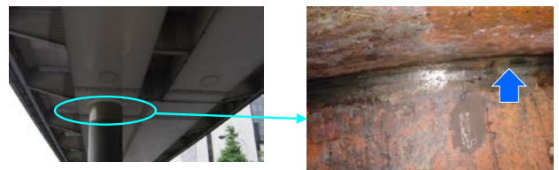
写真-2 鋼製橋脚隅角部の疲労き裂
