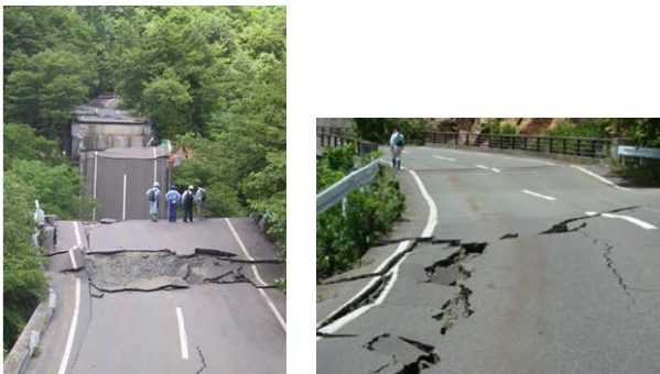
写真-6 地震による変状 左：斜面崩壊による落橋、右：橋台背面の陥没
