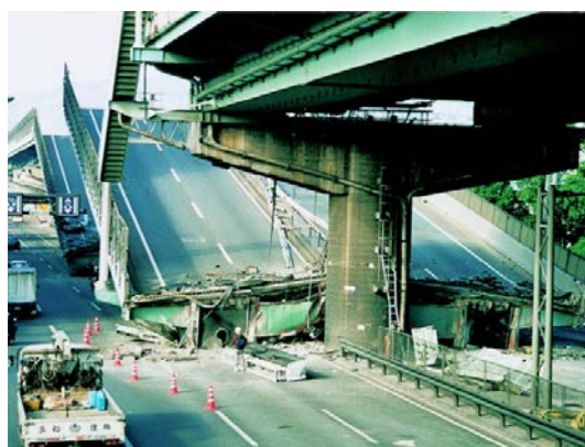
写真-1 解析対象橋の桁落下状況 3), 4)
