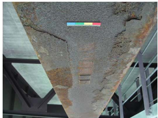
写真-4(1) 小水橋腐食状況（下フランジ下面）
