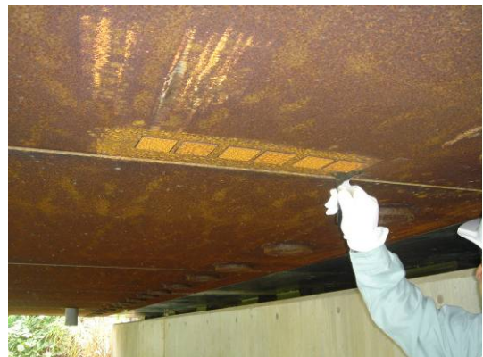
写真-4(2) 鰐淵橋腐食状況（床版橋、床版下面）
