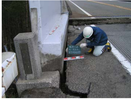
図-5 橋台ウイングの損傷状況（能登大橋）
