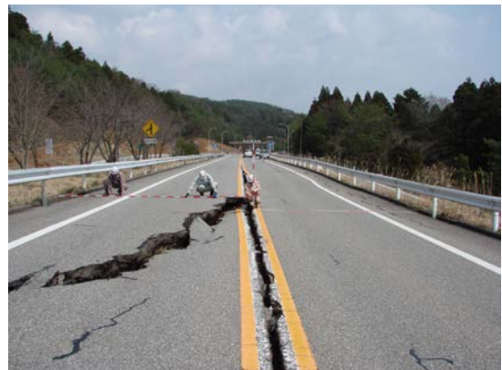
図-4 路面の段差・クラック状況
