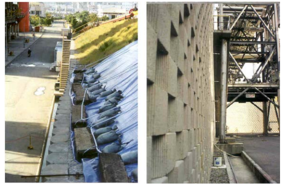
写真-1 補強土壁の崩壊事例
