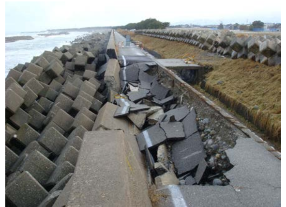
図-8 堤防の被災
