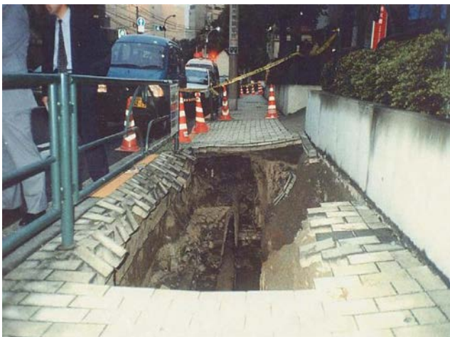
図-1 道路陥没の状況 2)
