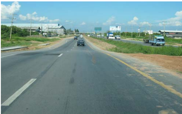
写真-3 ラマII世道路72km付近の状況(2006年)
