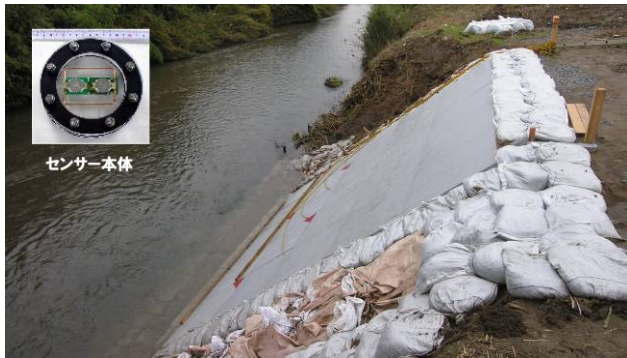
写真-1 変状検知センサーの現地試験
