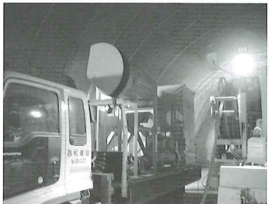
写真-10 排気エアカーテン
