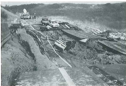
写真-1 国道44号北海道厚岸町糸魚沢の盛土の崩壊状況 1) (北海道開発局釧路開発建設部による)
