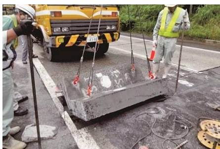
写真-1 損傷目地部（収縮目地）
