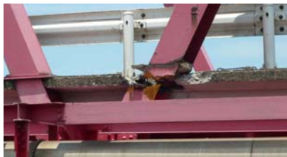
写真-1 トラス斜材破断事例1
