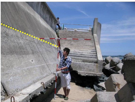
写真-4 シーサイドホテル付近での護岸の露出状況 (2010年5月30日)
