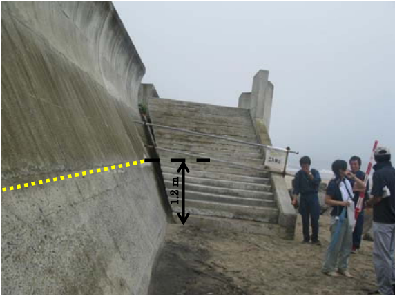
写真-3 シーサイドホテル付近での護岸の露出状況 (2009年7月9日)
