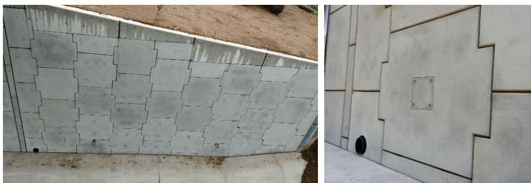
写真-5.1 富山県 コンクリート蓋式
