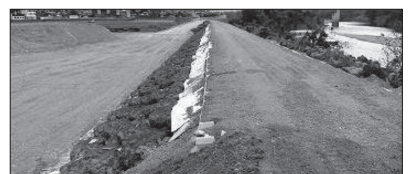
図-3 堤体裏法部越水対策としての使用例
