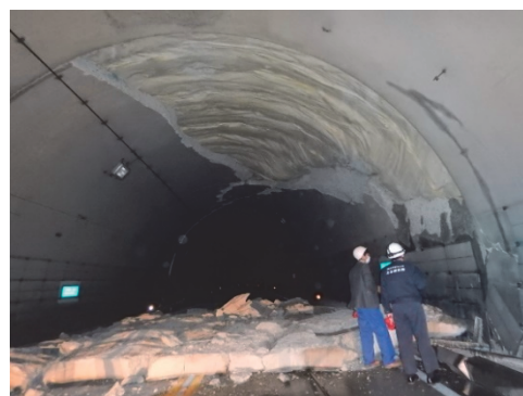
写真-1 俵山トンネルのスパン 167 付近の覆工コンクリート崩落状況
