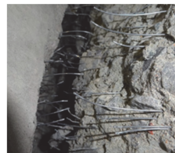
写真-6 破壊面の鋼繊維の状況
