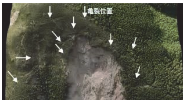
図-1 斜面上部に分布する亀裂の状況
