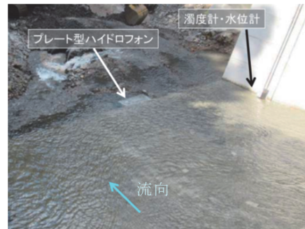
写真-5 写真-4中、プレート型ハイドロフォン、濁度計、水位計の設置状況
