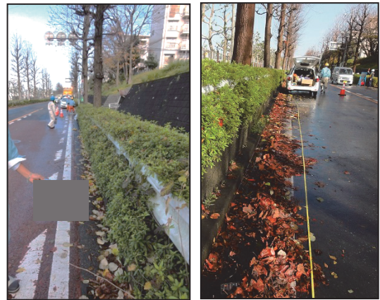
写真-1 柵蓋及び側溝上の落葉堆積状況
