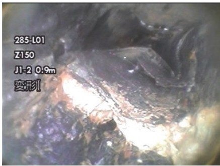
写真-2 閉塞した硬質瀝青管
