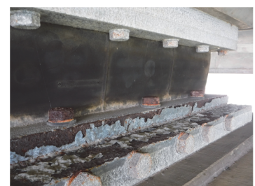
写真-2 支承部の腐食状況
