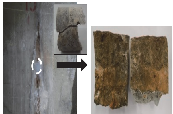
写真-1 錆汁が発生しているひび割れ面
