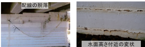
図-5 C橋の損傷状況
