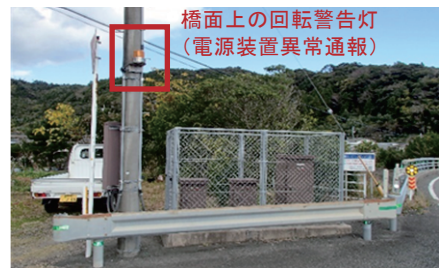
図-6 日常管理における通電の確認を支援する例
