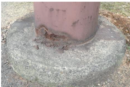
写真-7 支柱基部の補修前損傷状況
