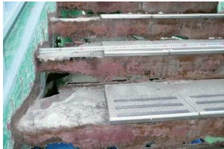
写真-10 階段部の補修前損傷状況（化粧鋼板撤去後）
