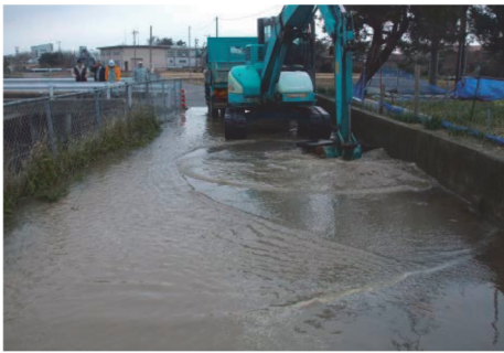
写真-1 圧送管の事故事例
