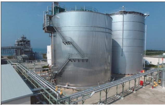
写真-1 鋼板製消化槽(手前)とガスホルダー(奥)
