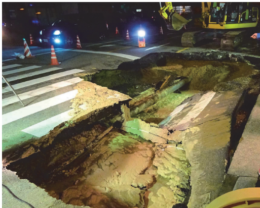
写真-1 圧送管路の事故事例
