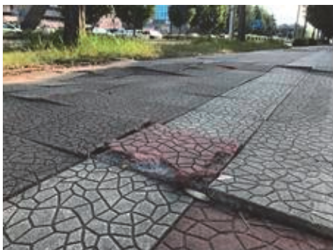
写真-6 根上がりによる歩道の不陸
