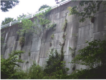
写真-10 補強土壁の植生の繁茂 10)
